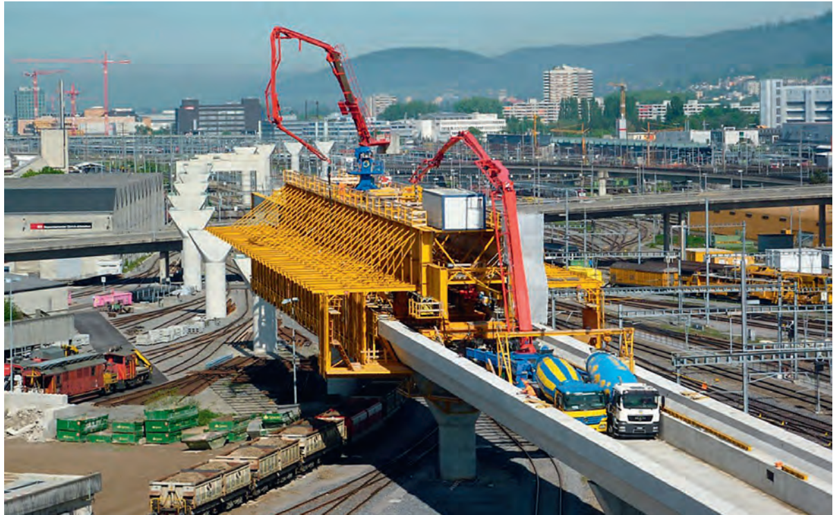
Fig. 4 Letzigrabenbrücke – Erstellung des Überbaus mittels Vorschubgerüst. Letzigraben bridge – erecting the superstructure using a movable scaffolding system.
