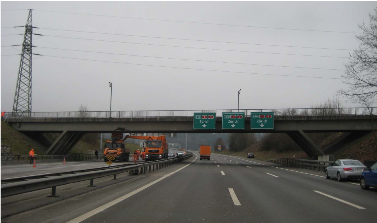
N1-419: Altes Bauwerk nach Unfall am 13.01.2014
