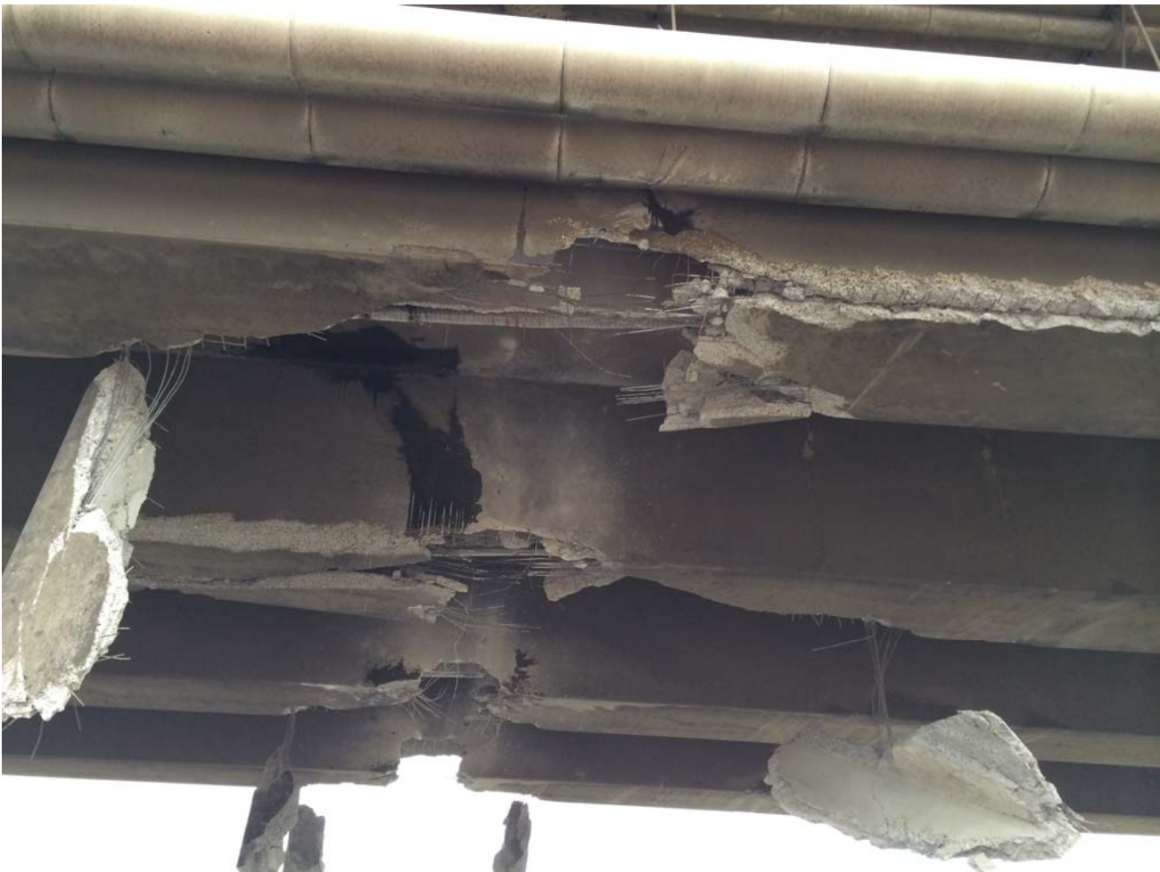
N1-419: Altes Bauwerk nach Unfall am 13.01.2014
