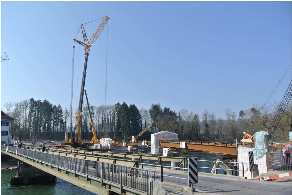
Blick Richtung Süden auf fertig versetzten Brückentrog. Im Vordergrund ist die bestehende Reussbrücke zu sehen.
